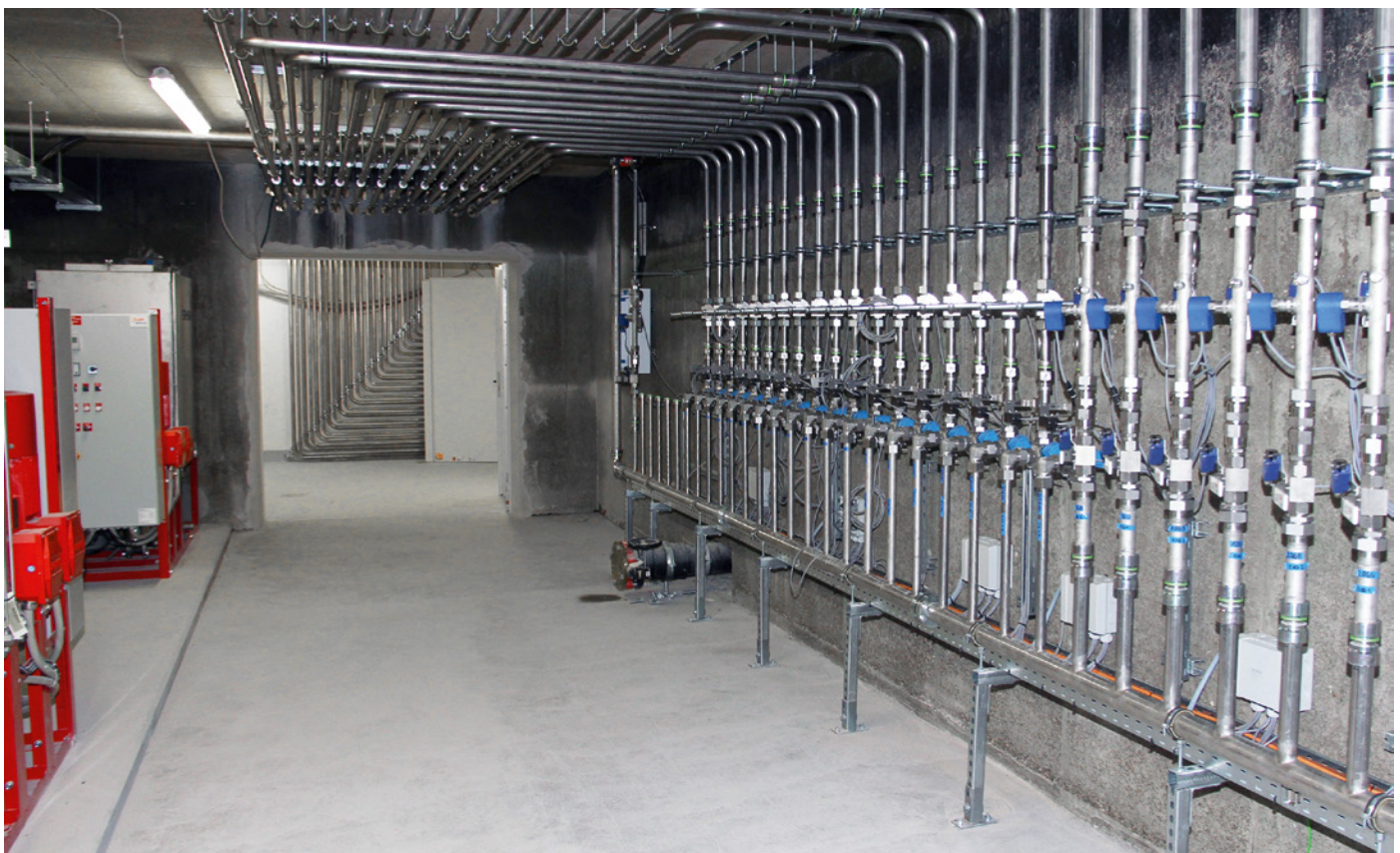
Die Pumpenzentrale einer HDWN-Löschanlage punktet selbst bei 29 Bereichsventilstationen mit ihrer geringen Einbaugröße.
